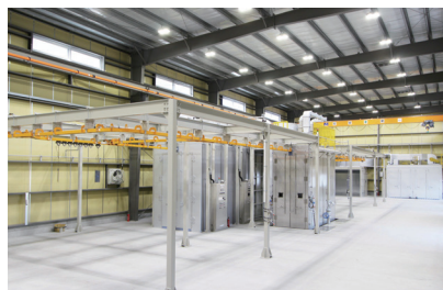
▲内部(プラント設置後)
